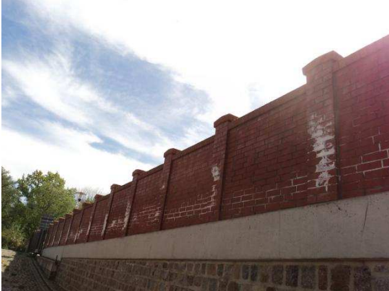
2018_AUSSINTERUNGEN IM WANDBEREICH
