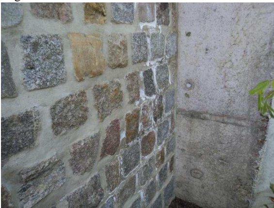
2018_AUSSINTERUNGEN IN SOCKELWAND
