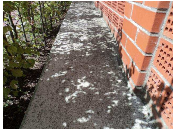
2018_BETONoberfläche DES KOPFBALKENS VERWITTERT
