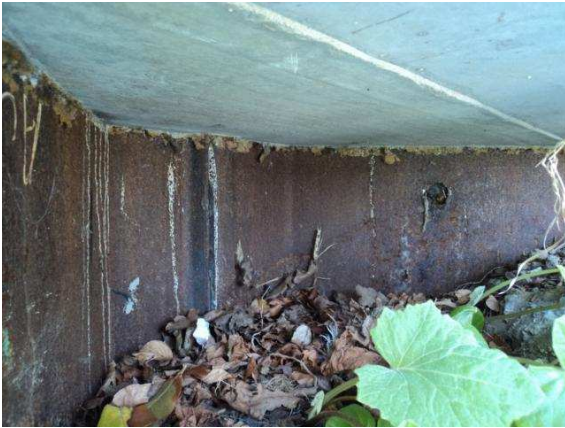
2018_SPUNDWANDGRÜNDUNG MIT KORROSION
