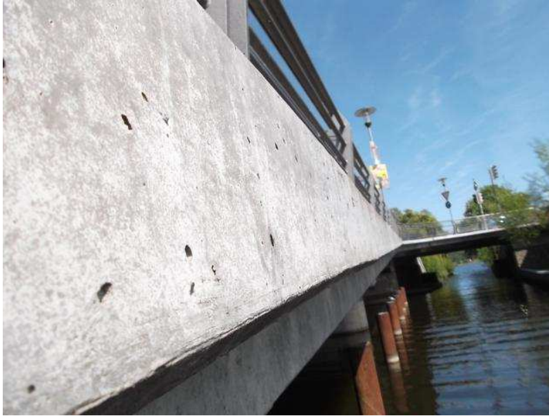
2018_SEITENFLÄCHE DES GESIMS MIT LUNKER
