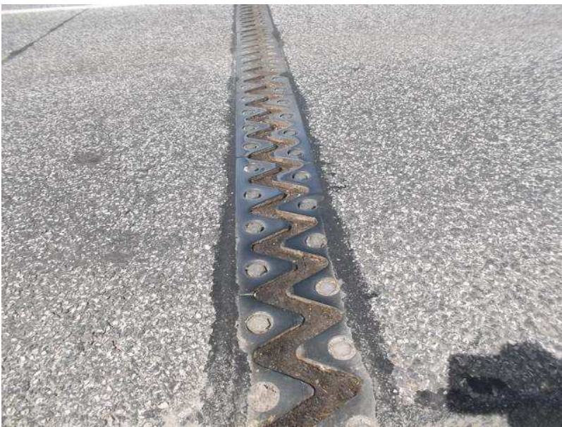
2018_VERSCHMUTZUNG DER ÜBERGANGSKONSTRUKTION
