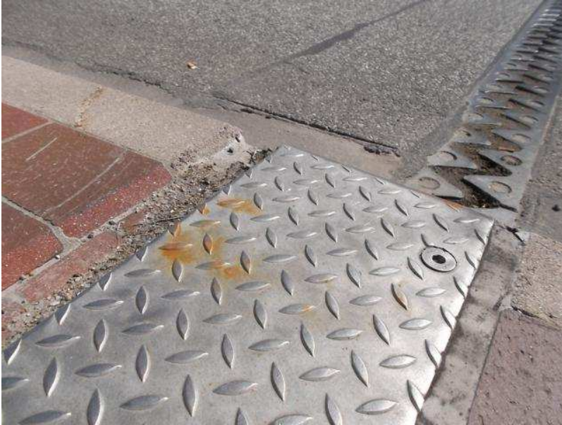
2018_ABDECKBLECH MIT KORROSION
