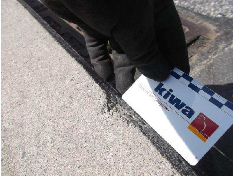
2018_BETON AM SCHRAMMBORD ABGEPLATZT
