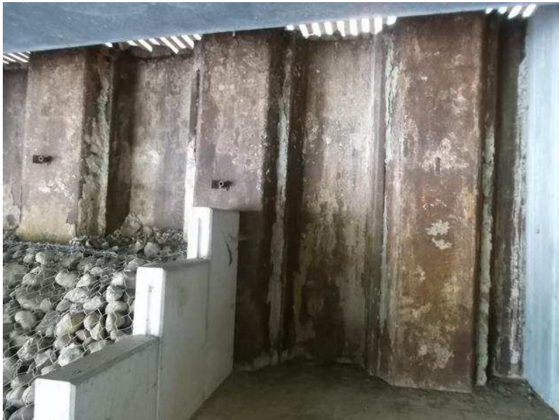
2018_SPUNDWANDGRÜNDUNG MIT KORROSION
