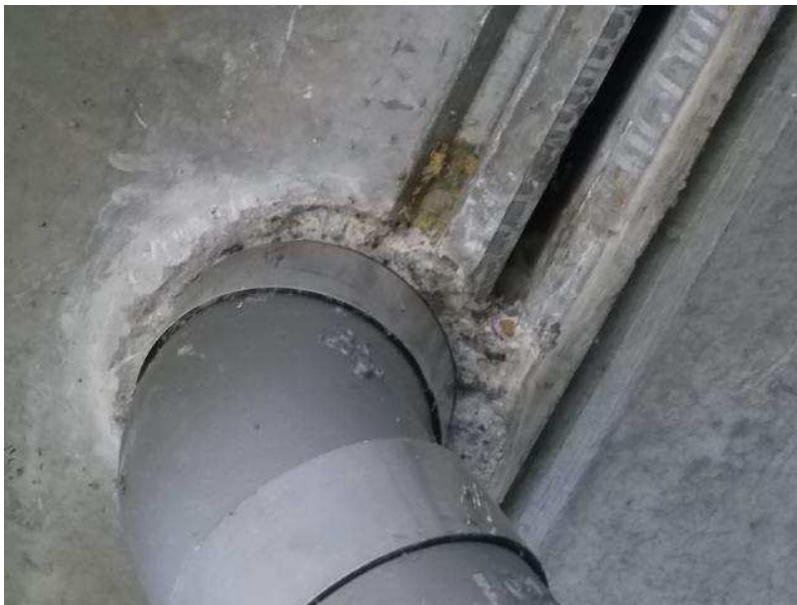
2018_VERSCHLUSS DES ROHRDURCHLASS MANGELHAFT
