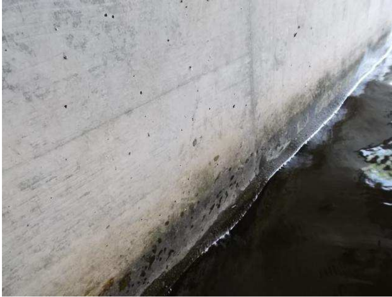
2018_BETON IN WWZ VERWITTERT
