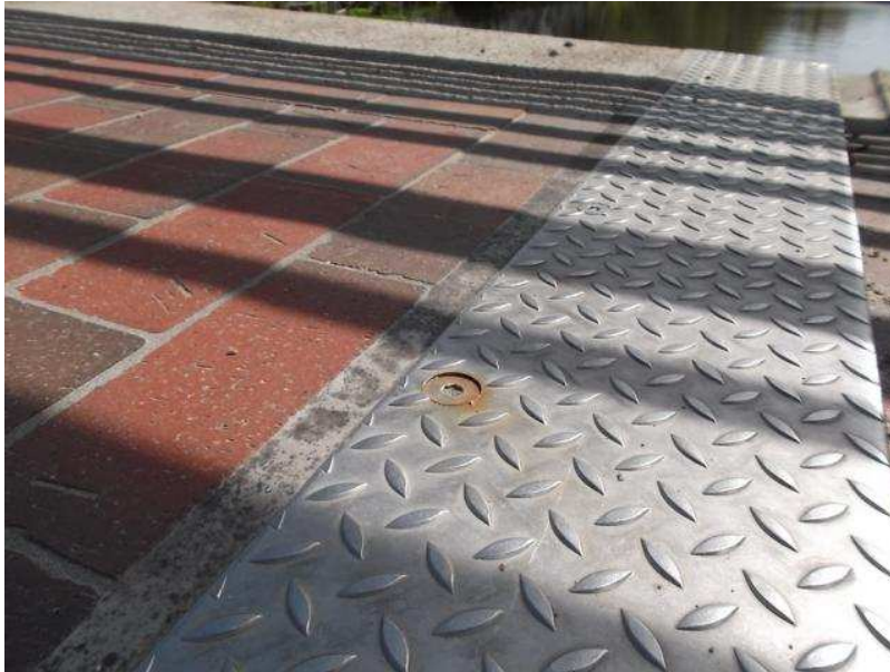
2018_VERSCHRAUBUNG DES ABDECKBLECHES MIT KORROSION
