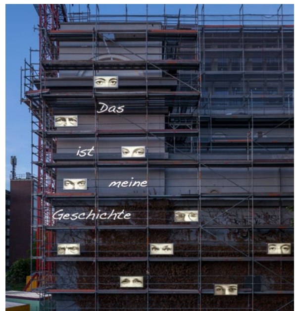
Kunstinstallation „Das ist meine Geschichte“ von Sabine Kammerl am Baugerüst während des Umbaus
