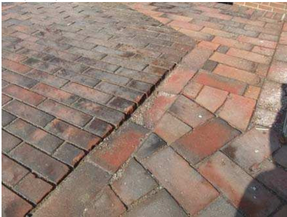
ABSACKUNG IM GEHWEG
