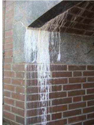
AUSSINTERUNGEN AM KÄMPFER FUßGÄNGERDURCHGANG NO
