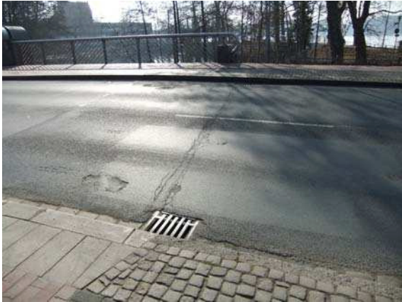
FAHRBAHNBELAG MIT QUERRISSEN
