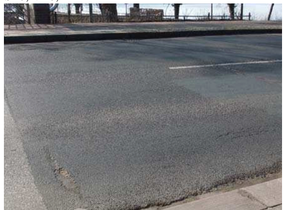
LÄNGSRISSE IM FAHRBAHNBELAG
