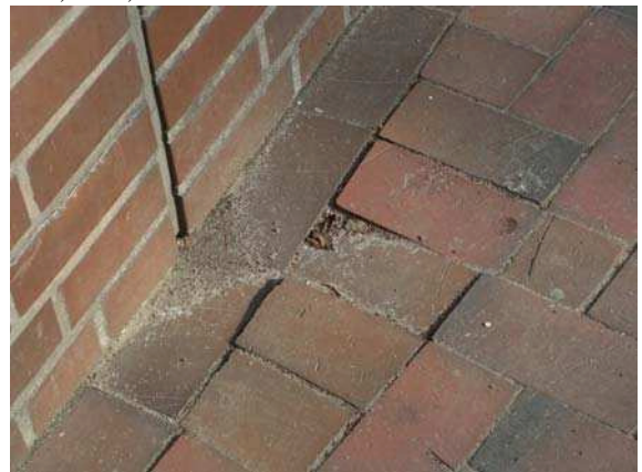
GEHWEG LINKS ABSACKUNGEN
