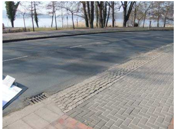
SCHADHAFTER BELAG VOR DEM BAUWERK
