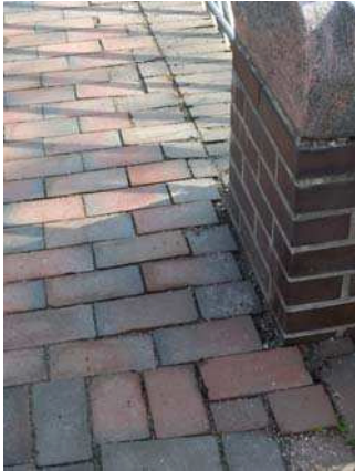
PFLASTER AM PFEILER SW
