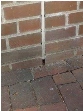
AUSGEBROCHENE FUGENMASSE AN BRÜSTUNGSWAND
