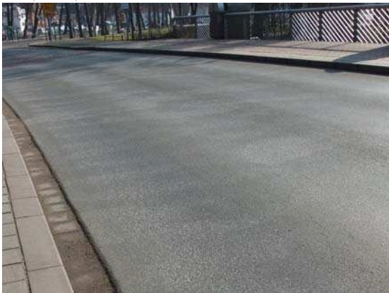
SPURRINEN GESAMTE FAHRBAHN
