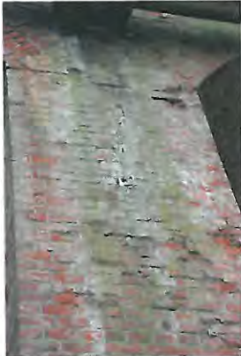
HP_2012_PFEILER_ACHSE30_NORDSTIRNSEITE [18] Pfeilerkopf, Pfeiler als Vollquerschnitt, tragendes Mauerwerk, eine Stelle, herausgebrochen, Fläche: 0,50 m 2 , Pfeiler Achse 20, Ansichtsfläche West, Mauerwerksausbruch bis 15 cm Tiefe HP 2012: Schadensbild unverändert, teilweise Schadenerweiterung S=2, V=1, D=3 EP
