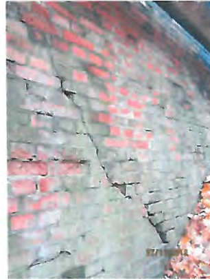
HP_2012_FLÜGELWAND_NW [34] Flügel, tragendes Mauerwerk, eine Stelle, Schrägrisse, NO S=2, V=0, D=2 EP
