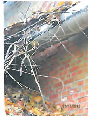
HP_2012_FLÜGELWAND_NO [26] Flügel, tragendes Mauerwerk, ein Stück, Schrägriss, Breite 1,2 mm, SW S=2, V=0, D=2 EP
