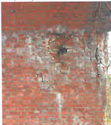
HP_2012_MW-AUSBRUCH_ACHSE20_WESTSEITE [22] Pfeilerfuß, Pfeiler als Vollquerschnitt, tragendes Mauerwerk, eine Stelle, herausgebrochen, 2. Stützenbereich, Norden, Mauerwerksausbruch an nordwestlicher Pfeilerecke Achse 30, Tiefe bis 25 cm HP 2012: Schaden unverändert, Auskolkungen S=2, V=0, D=3 EP
