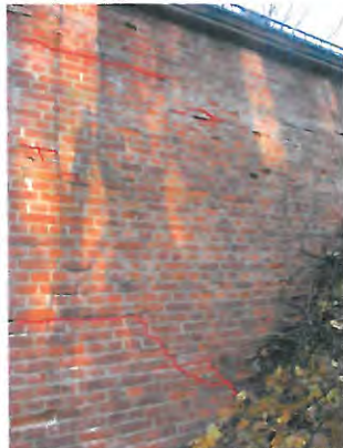
HP_2012_FLÜGELWAND_SO [24] Flügel, tragendes Mauerwerk, mehrfach, Schrägrisse, vorne und hinten am Bauwerk, beidseitig, alter Schaden nicht behoben, Rissweiten bis 2 cm HP 2012: Schadensbild unverändert, Flügelwände durchfeuchtet S=2, V=0, D=2 EP
