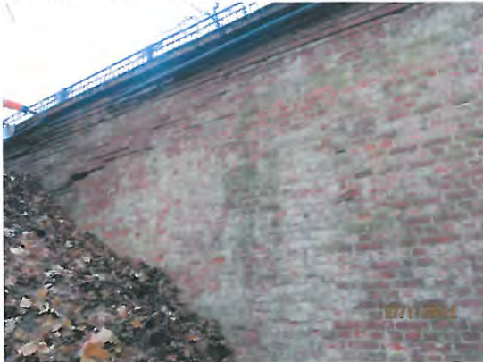
HP_2012_FLÜGELWAND_SÜDWEST [31] Flügel, tragendes Mauerwerk, vereinzelt, Querrisse, teilweise Schrägrisse, schadhafte Fugen, Mauerwerksabplatzungen und -ausbrüche, Frostschäden, alle Flügelwände S=1, V=0, D=2 EP
