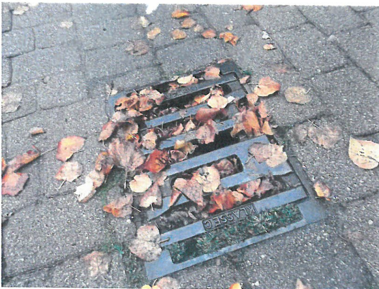
2015_SCHMUTZABLAGERUNG IN DER BAUWERKSENTWÄSSERUNG
