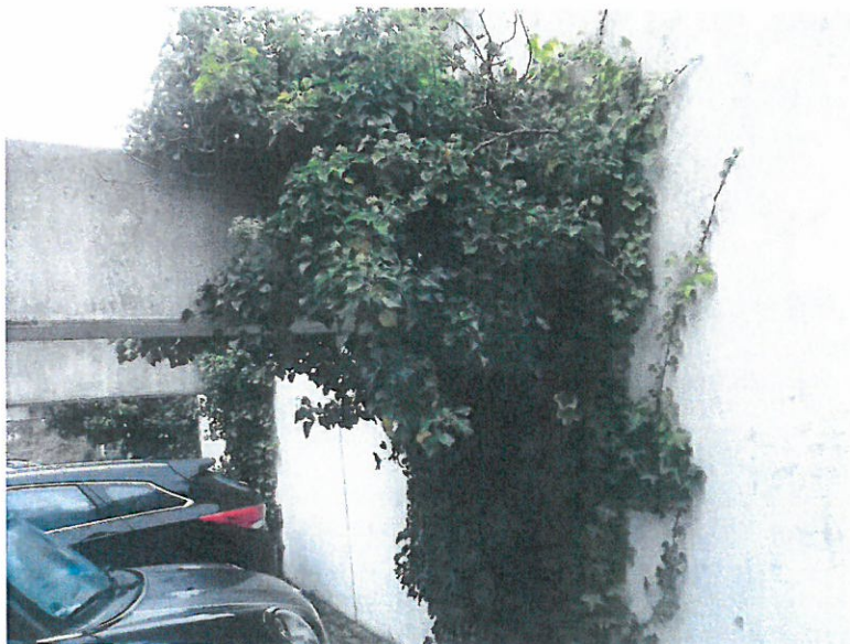
2015_GEFAHR DURCH BEWUCHS
