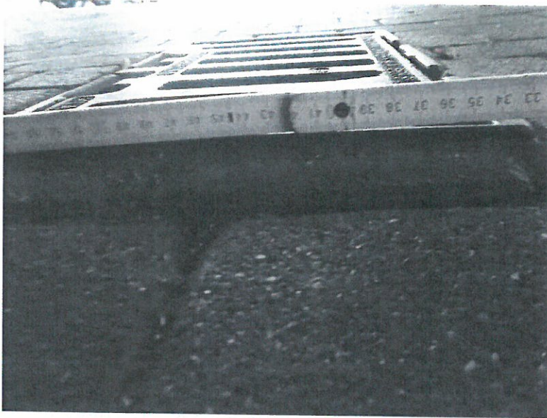
2015_SETZUNG IM BEREICH DER ENTWÄSSERUNGSEINLÄUFE
