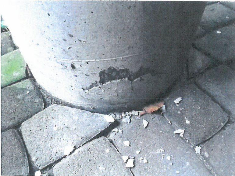
2015_ABPLATZUNGEN IM FUSSPUNKTBEREICH STÜTZE
