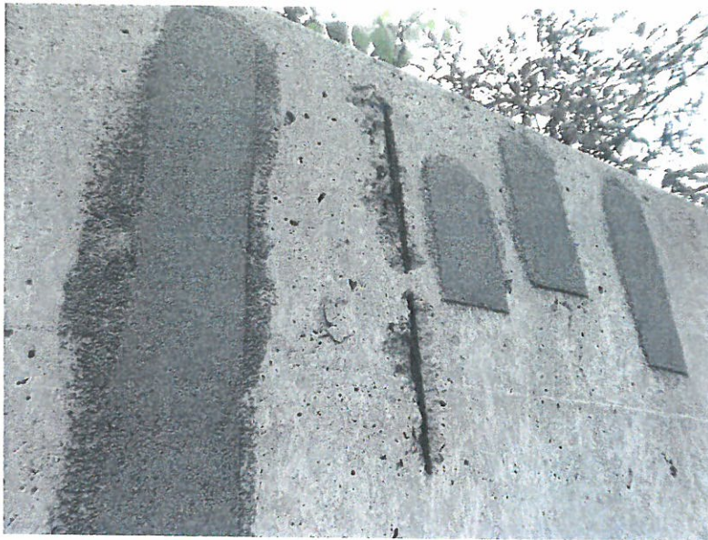
2015_BETONABPLATZUNGEN MIT FREILIEGENDER BEWEHRUNG
