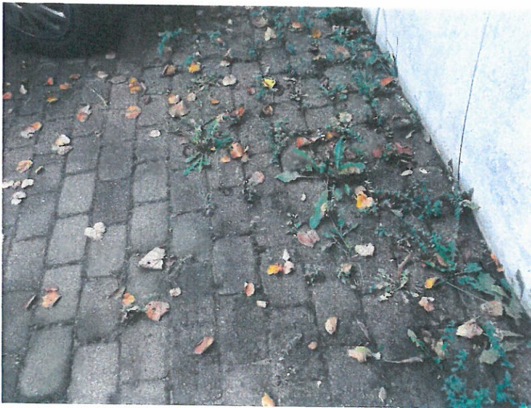
2015_BEWUCHS IM PFLASTERBELAG
