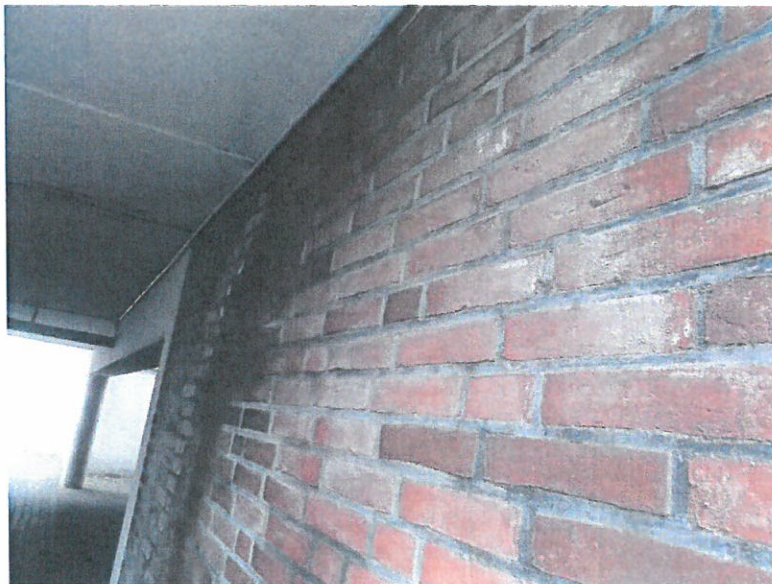
2015_MAUERWERK MIT AUSSINTERUNGEN
