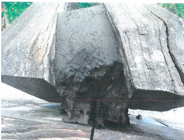
2015_FÄULNIS IM KOPFBEREICH DER BALKEN
