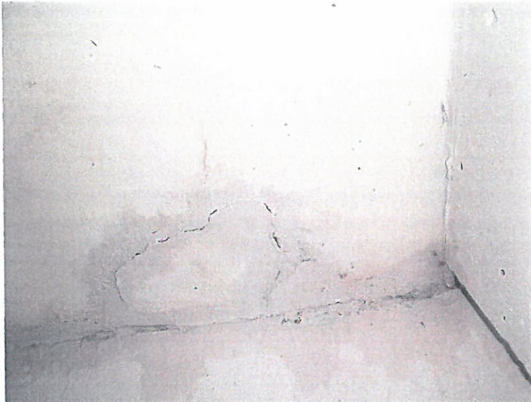
2015_BETONABPLATZUNG MIT FEUCHTIGKEIT
