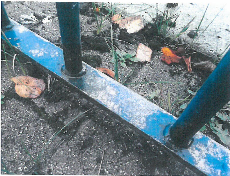
2015_KORROSIONSSCHUTZ DES GELÄNDERS VERWITTERT
