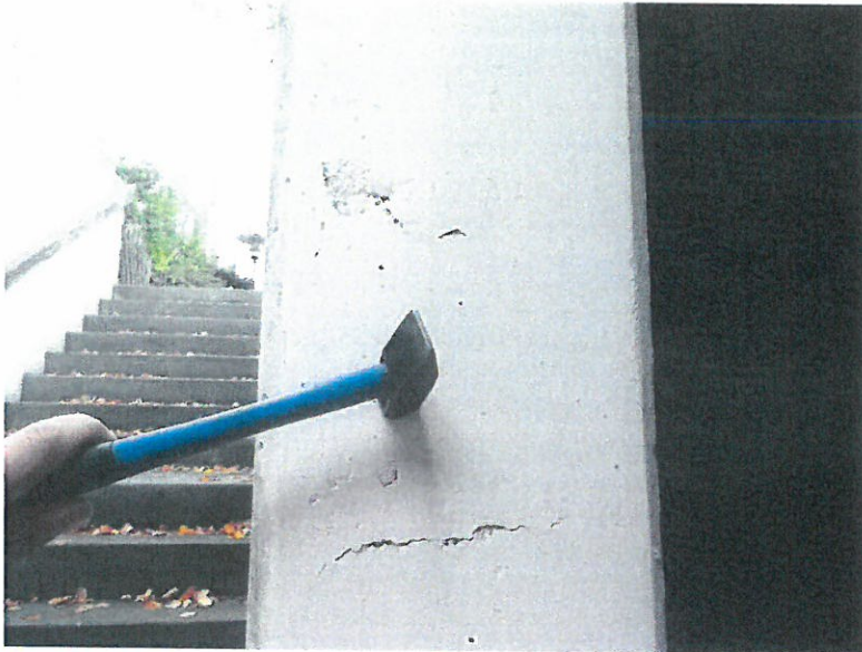
2015_BETONABPLATZUNGEN NEBEN TREPPE
