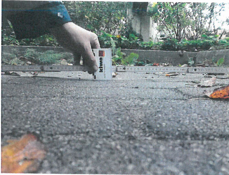
2015_SETZUNGEN IM PFLASTERBELAG UNTER DEM BAUWERK
