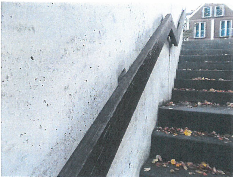
2015_HOLZSCHUTZ HANDLAUF VERWITTERT
