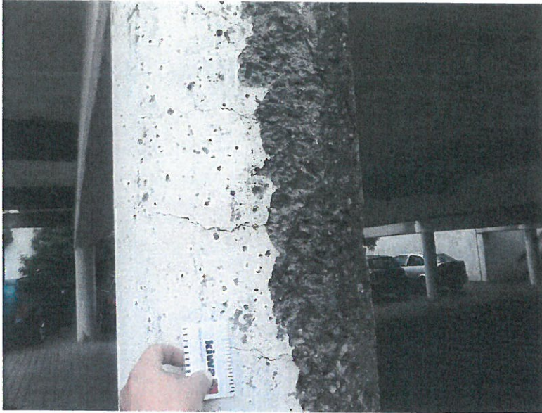
2015_AUSGEBRÄGTE BETONABPLATZUNGEN MIT RISSE
