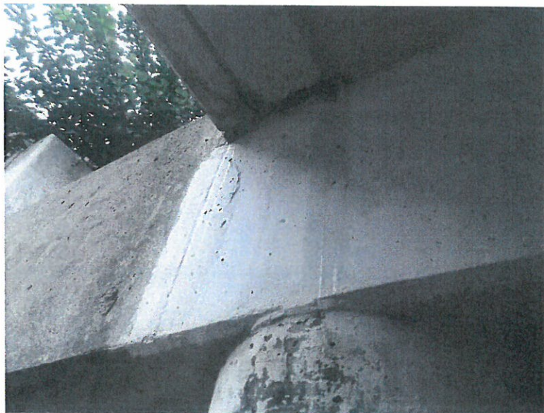
2015_RISSE UND FEUCHTIGKEIT AM QUERBALKEN
