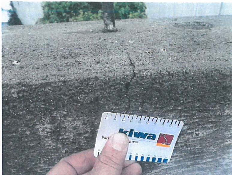
2015_BRÜSTUNG MIT RISSERSCHENUNGEN
