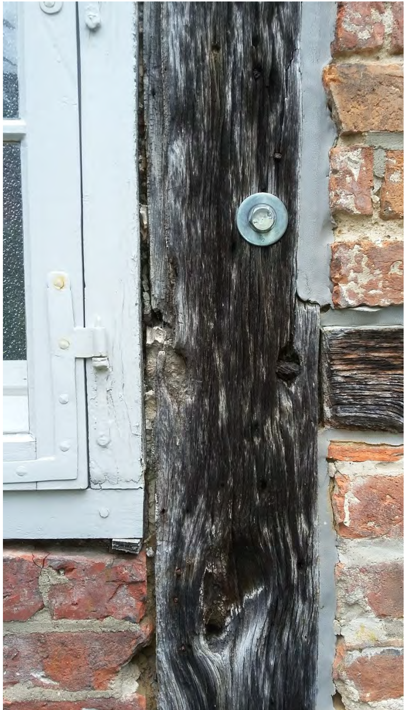
Offene Fugen zwischen Holz und Mauerwerk, Dichtfugenmassen unterschiedlichster Breiten mit Flankenabrissen, offene Fugen zu Fenster
