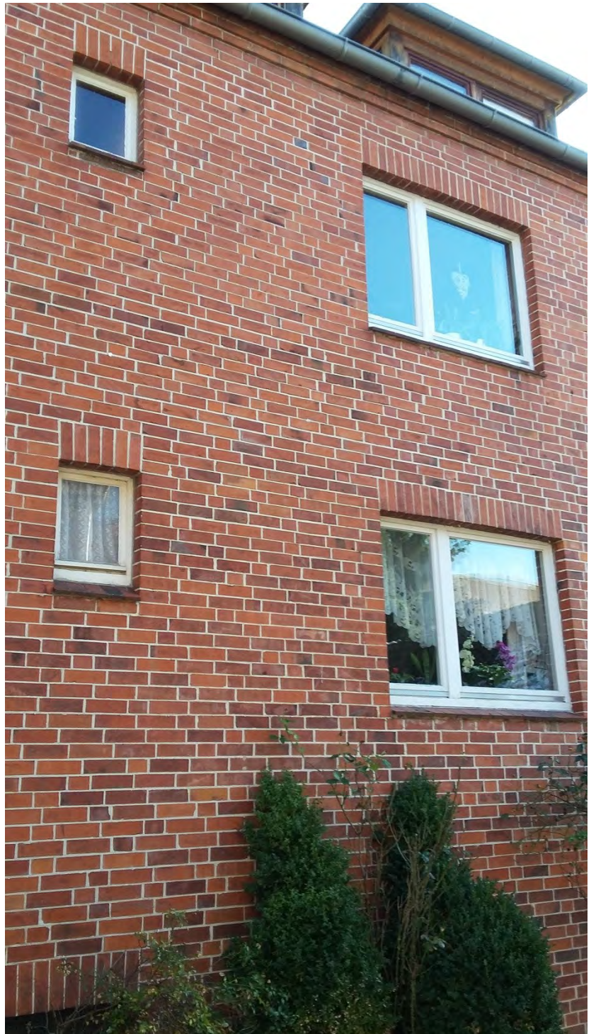
Kleine Fenster einfachverglast, verbleibende Fenster mit Wartungsstau
