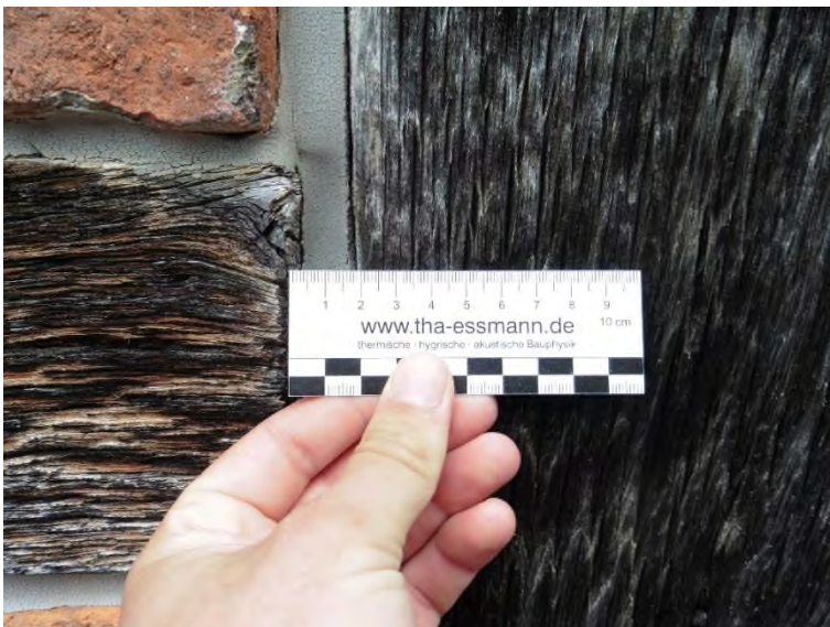
Bild 3 Fachwerkwand / Flankenabriss des Dichtstoffes
