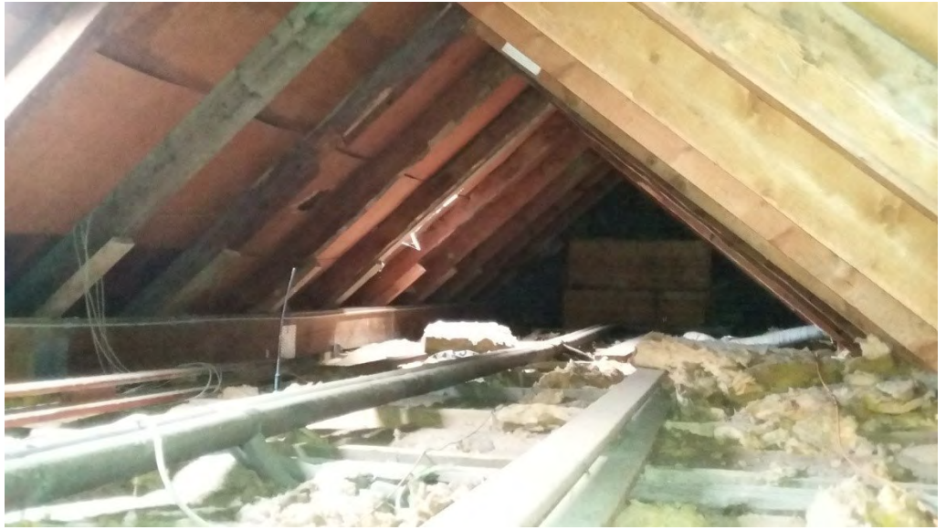
Dachboden Barlachplatz mit undefinierbarer Dämmebene, Windoffen
