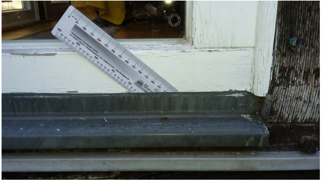
Fallende offene Fuge am Wetterschenkel
