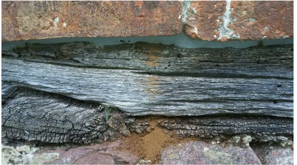
Vermorschte Schwelle im Erdgeschoss des Fachwerkes
