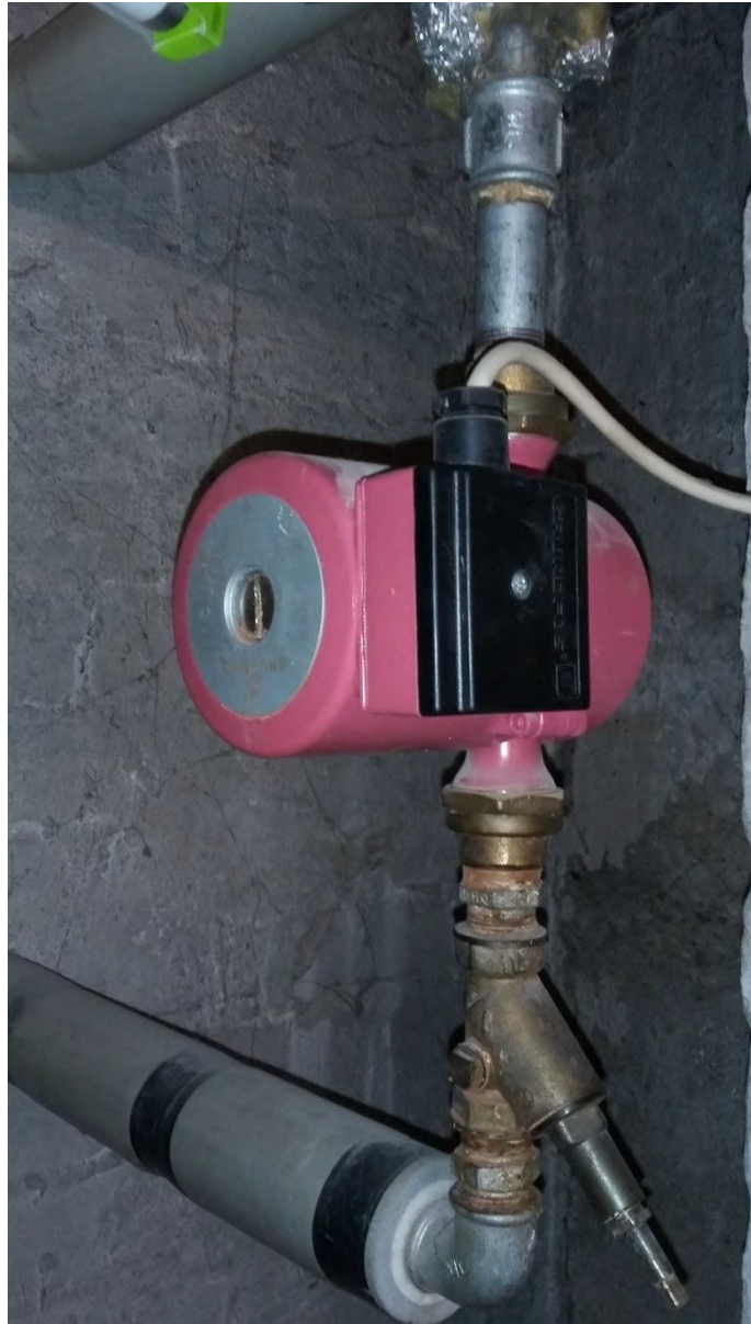
Pumpe ineffizienter Bauart
