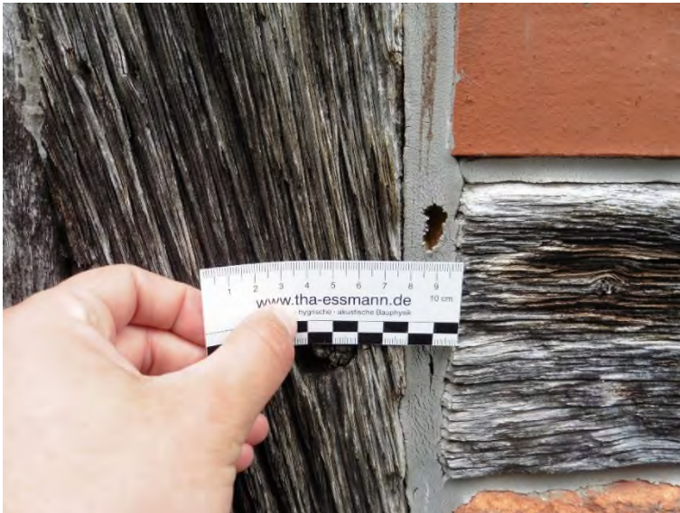
Bild 2 Fachwerkwand / Schadhafter Dichtstoff
