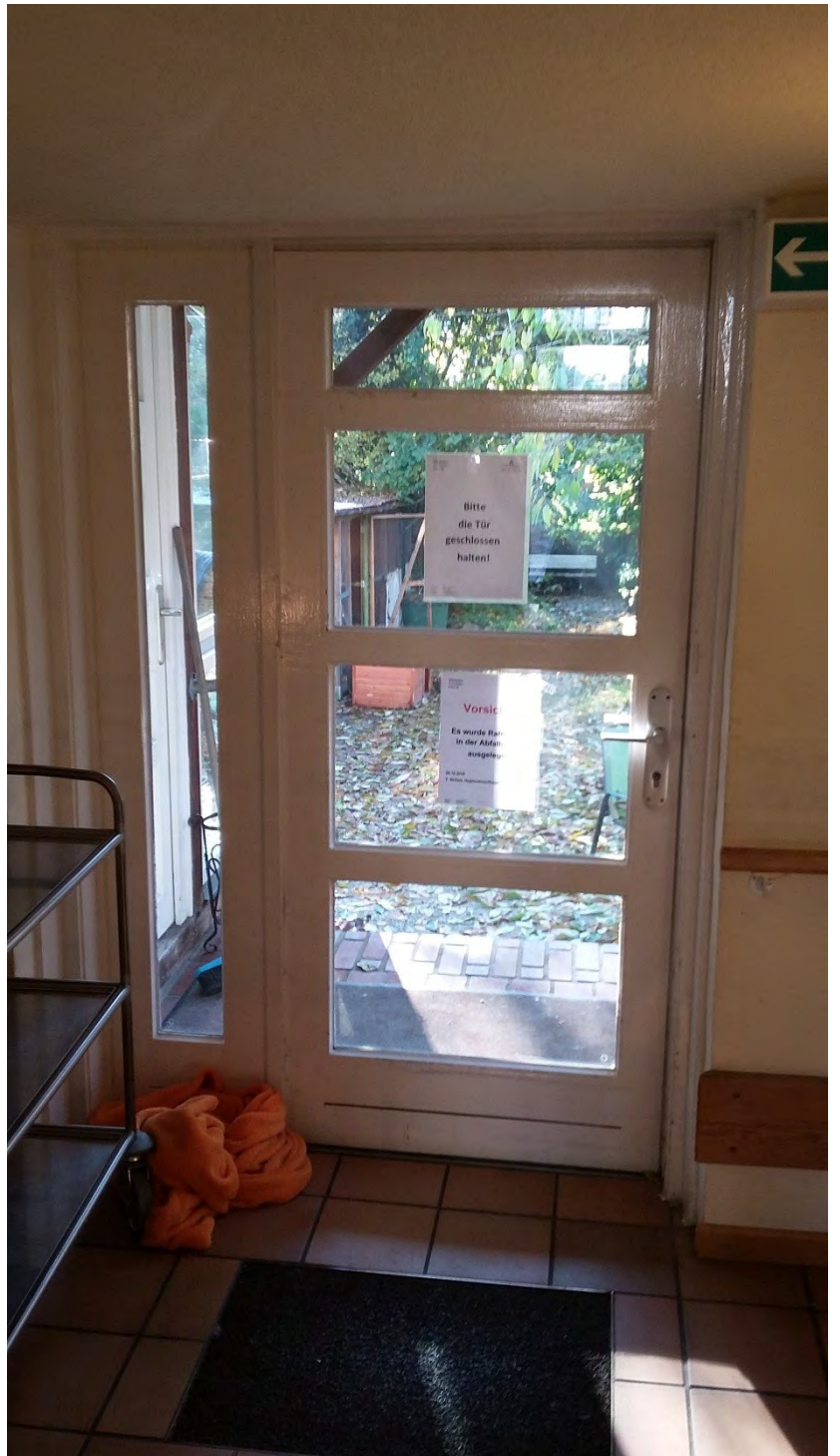
Tür mit Seitenteil einfachverglast, Flügel ohne Dichtungen, verworfenes Türblatt
