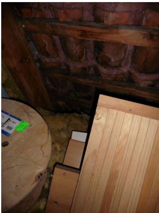
Bild 20 Steildach (Abseite) ohne Wärmedämmung
