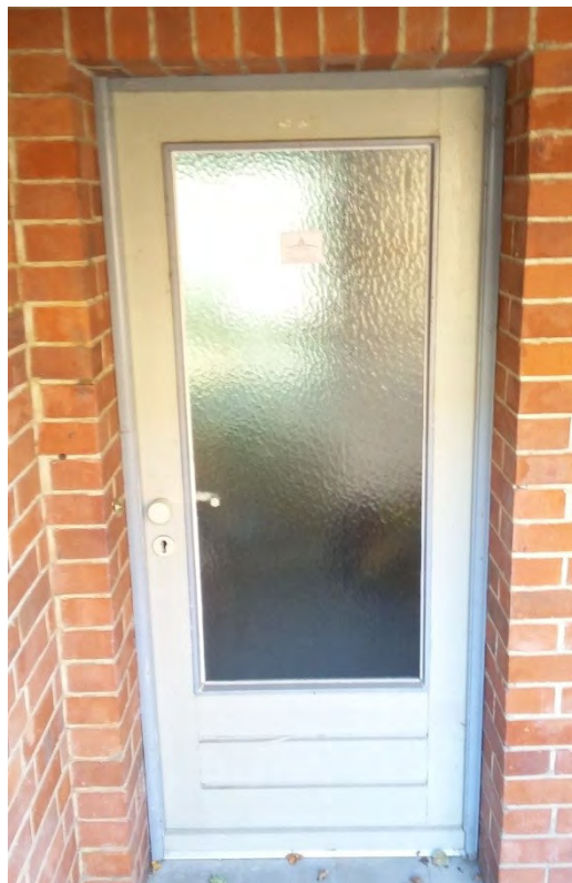
Nebeneingangstür einfachverglast, keine Dichtungen
