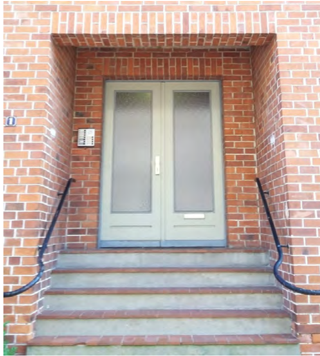
Hauseingangstür einfachverglast, Briefschlitz, keine Dichtungen
