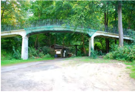
Abbildung 43: gesperrte Kamelbrücke (S.T.E.R.N. GmbH)
