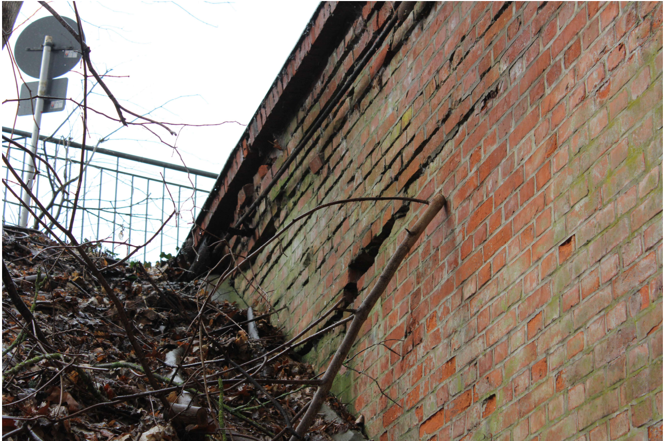
Abbildung 22: Riss / Verschiebung FW auf Süd-Ostseite
