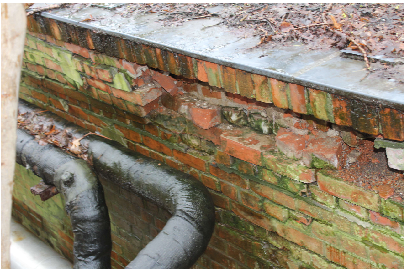
Abbildung 23: Schäden Gesims/FW-Kopfbereich auf Nord-Westseite
