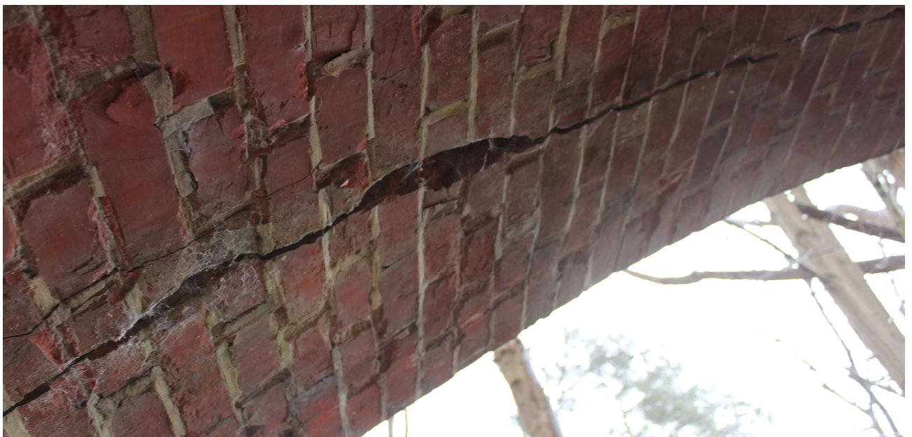
Abbildung 14: Riss mit Abplatzungen
