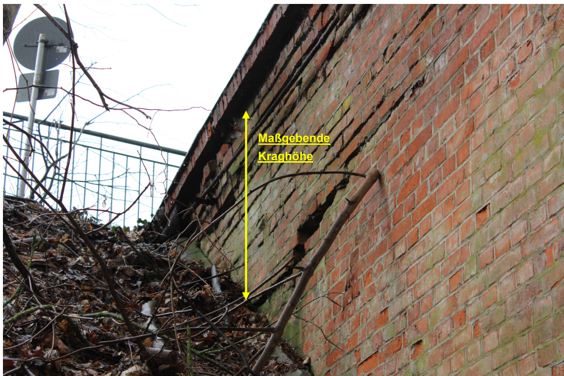
Abbildung 6: Riss auf der Süd-Ostwand des südwestlichen Widerlagers: Maßgebende Kraghöhe Flügelwand
