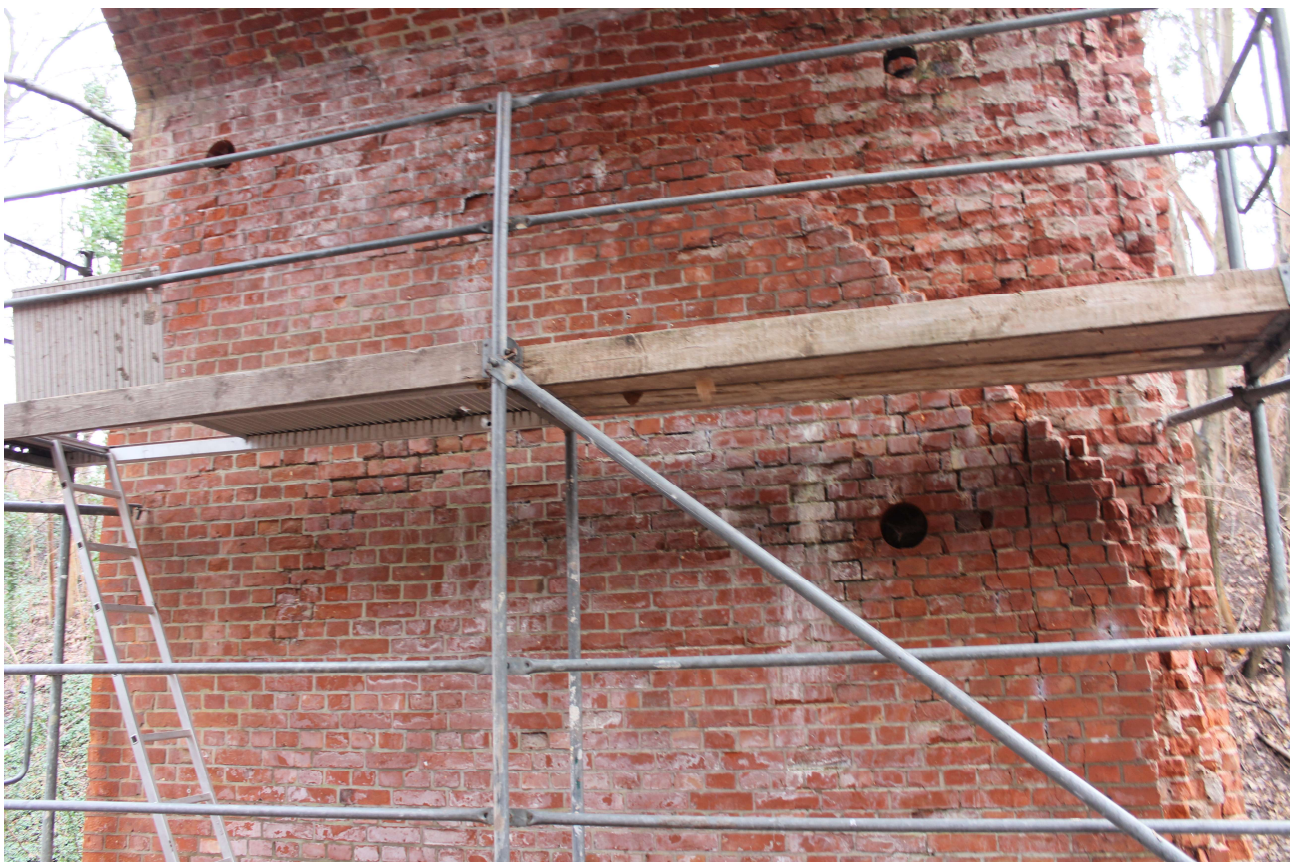
Abbildung 27: Pfeiler vorne Ansicht vom 1. Feld
