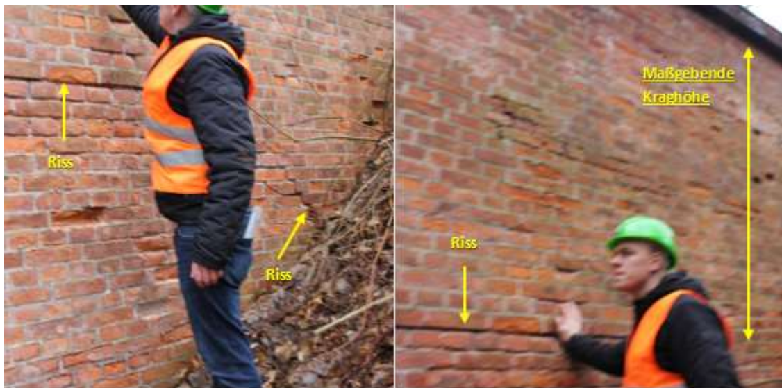
Abbildung 7: Riss auf der Süd-Ostwand des nordöstlichen Widerlagers: Maßgebende Kraghöhe Flügelwand
