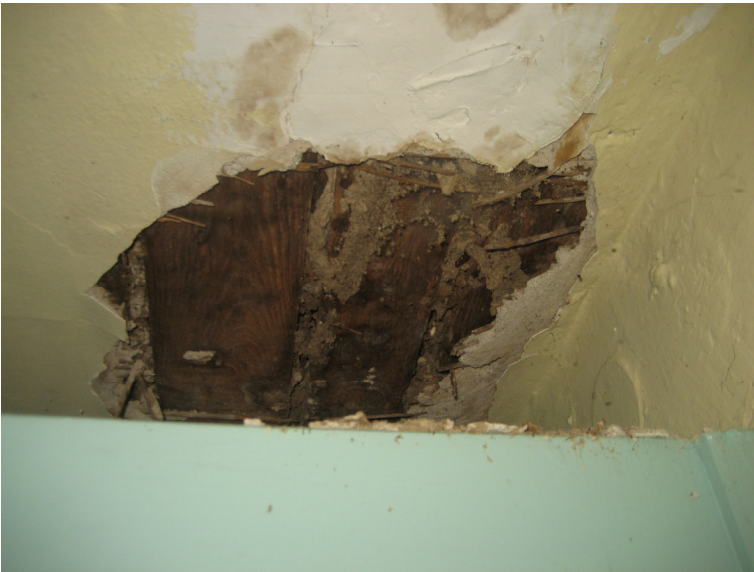
Wasserschaden an der Decke über Umkleide Raum 0.09
