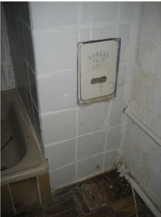
Stillgelegter Schornstein Raum 0.07
