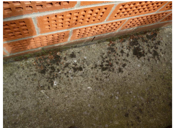
2021_ BETONoberFLÄCHE DES RIEGELS VERWITTERT
