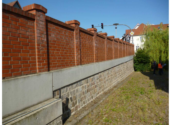
2021_AUSSINTERUNGEN IM WANDBEREICH
