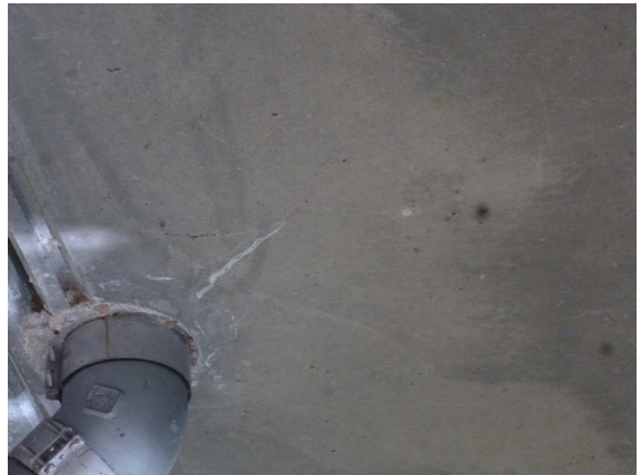
2021_RISSE AN PLATTE UNTERSEITIG MIT AUSSINTERUNGEN
