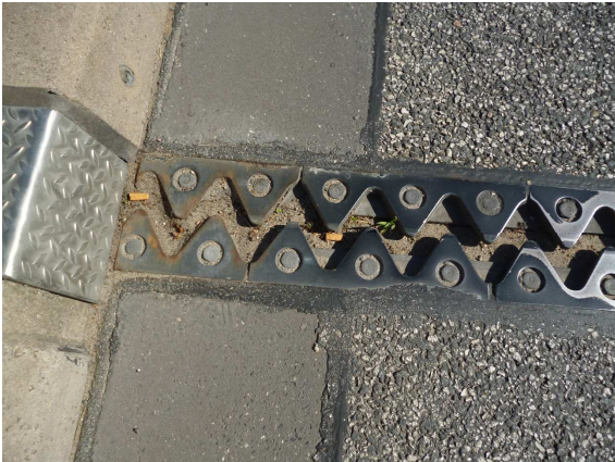
2021_VERSCHMUTZUNG DER ÜBERGANGSKONSTRUKTION
