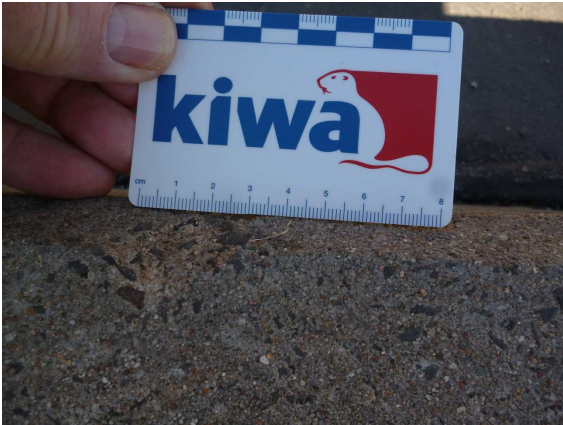
2021_BETON AM SCHRAMMBORD ABGEPLATZT
