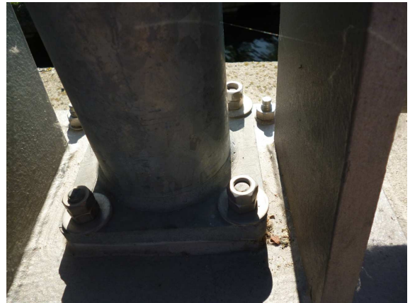
2021_VERANKERUNG DER BAUWERKSBELEUCHTUNG
