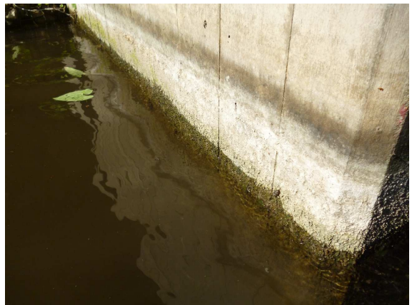
2021_BETON IN WWZ VERWITTERT
