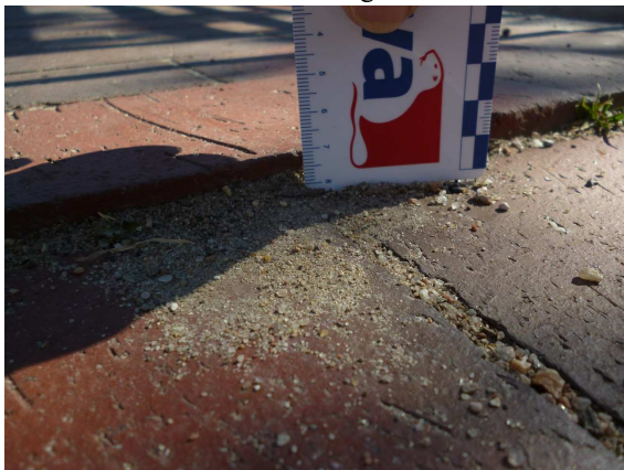
2021_VERSATZ IM PFLASTERBELAG
