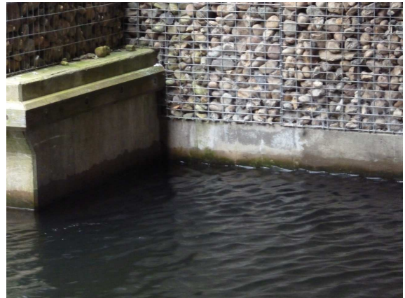
2021_AUFLAGERBANK MIT MOOS- UND ALGENBELAG
