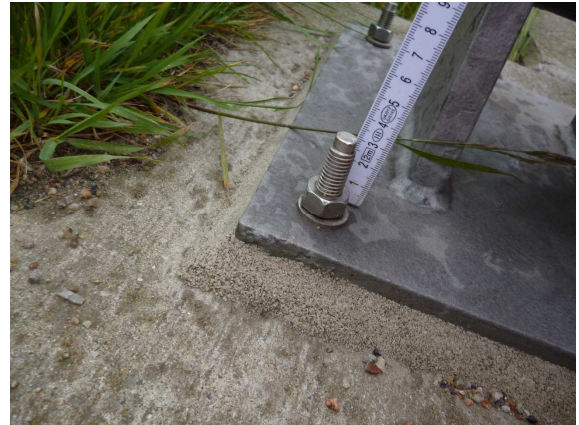
2021_BOLZEN DER VERANKERUNG ZU LANG
