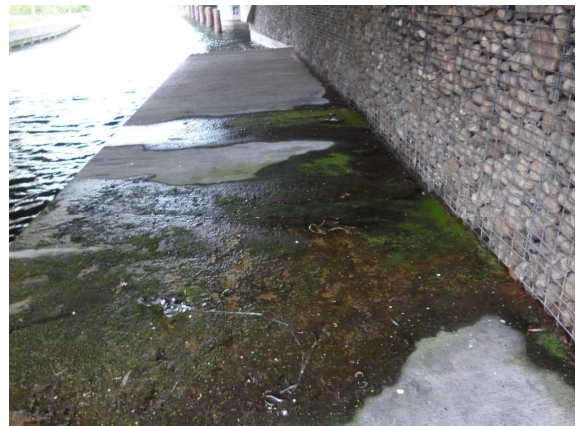
2021_AUFLAGERBANK NASS MIT MOOS- UND ALGENBELAG
