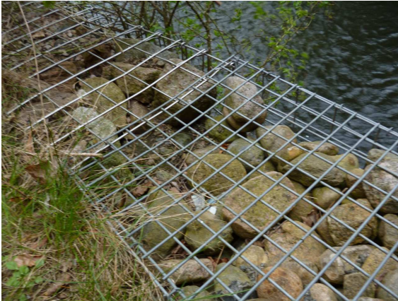
2021_GABIONENKORB NICHT VOLLSTÄNDIG GEFÜLLT
