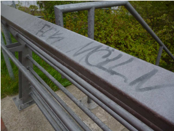
2021_HANDLAUF DES GELÄNDERS MIT SCHMIEREREIEN
