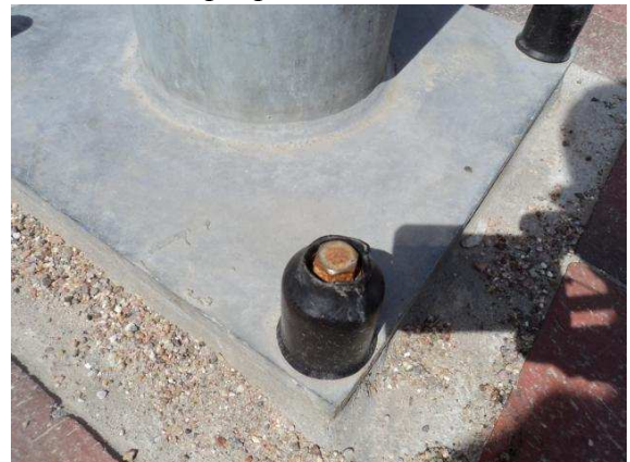
2018_BOLZEN DER AMPELVERANKERUNG MIT KORROSION
