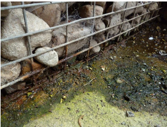
2021_GABIONENKORB MIT KORROSION
