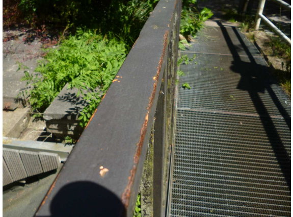
2021_GELÄNDER FUßWEG BESCHICHTUNGSABPLATZUNGEN
