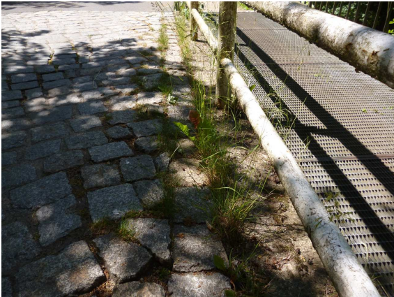
2021_ BEWUCHS ENTLANG DER FAHRBAHN [14] S=0, V=1, D=0 BSP-ID 241-01 Überbau, Geh- und Radwegbelag, Beton, Bereichsweise, Absatz, Vorne am Bauwerk, Rechts, Oben auf dem Bauwerk
