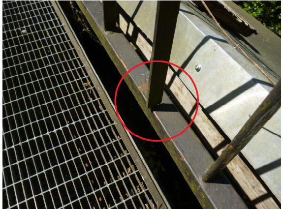
2021_SCHWEIßNAHT DEFEKT GELÄNDER
