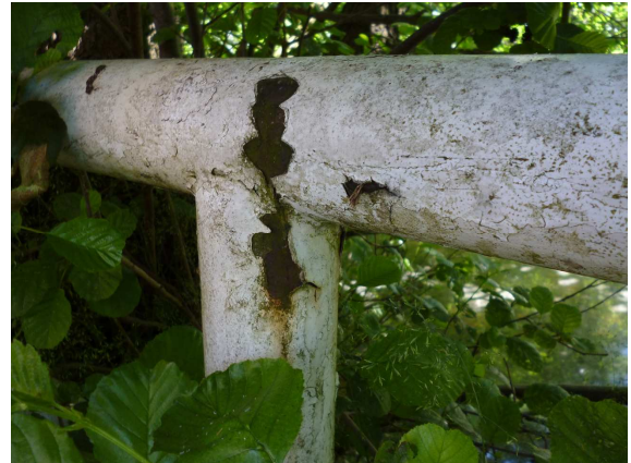
2021_KORROSION AM GELÄNDER
