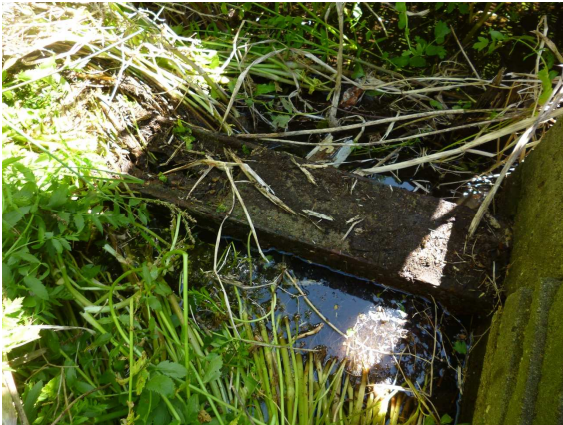
2021_ÜBERLAUF WEHRWAND DURCHKORRODIERT
