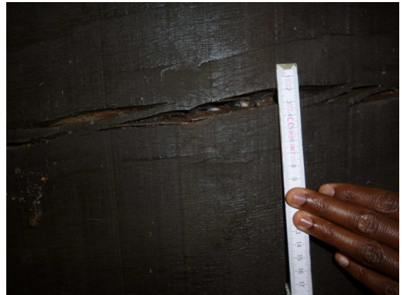
2021_HAUPTTRÄGER MATERIALBEDING GERISSEN
