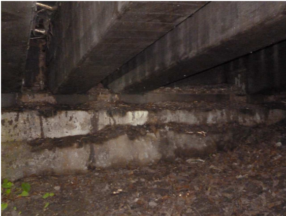
2021_AUFLAGERBANK VERSCHMUTZT UND VERWITTERT
