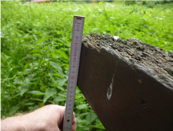
2021_VERROTTUNGSERSCHEINUNG AM HANDLAUF LINKS
