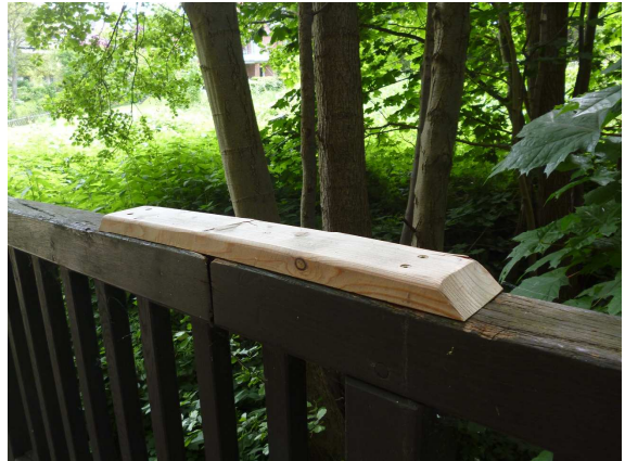
2021_NICHT FACHGERECHTE INSTANDSETZUNG IM DEHNSTOSSBEREICH
