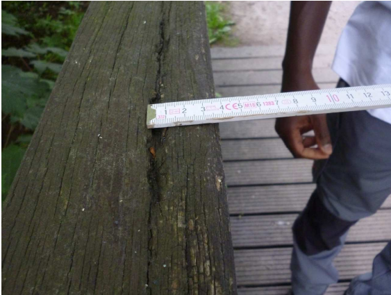
2021_HANDLAUF MATERIALBEDINGT GERISSEN
