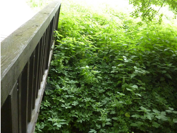
2021_BEWUCHS IM BÖSCHUNGSBEREICH
