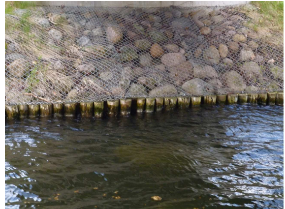
2021_VERROTUNGSERSCHINUNGEN AM KOLKSCHUTZ
