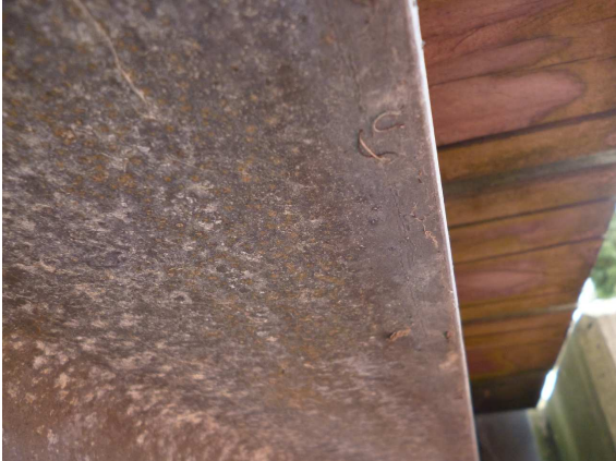
2021_WEISSROSTKORROSION AN DER STAHLKONSTRUKTION
