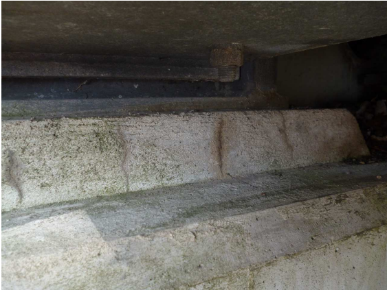
2021_AUFLAGERBANK MIT RISSEN
