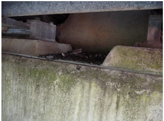
2021_AUFLAGERBANK MIT SCHMUTZABLAGERUNGEN
