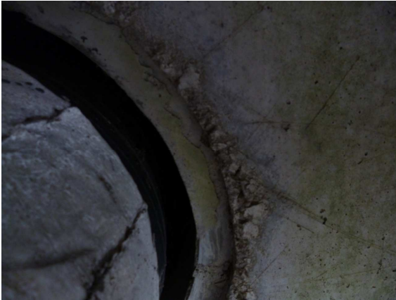
2021_KIESNEST IM BEREICH DER ROHRDURCHFÜHRUNG
