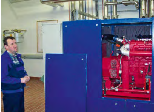
Der stellvertretende Klärwerksleiter Andreas Meier präsentiert das klärwerkseigene Blockheizkraftwerk.
