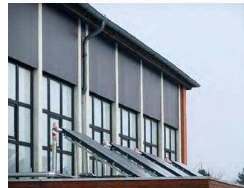
Solarthermieanlage in Betrieb genommen.
