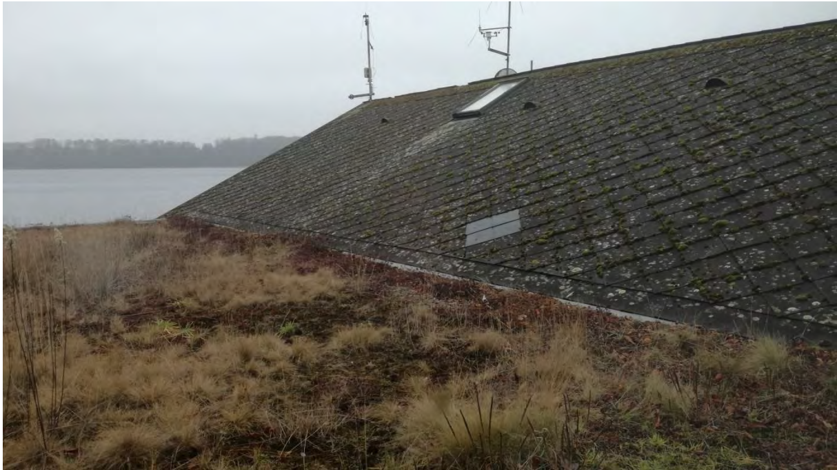
Dach und auch Dachfenster abgedichtet, Lüftungssteine ebenfalls nicht zugänglich (s.o.).
