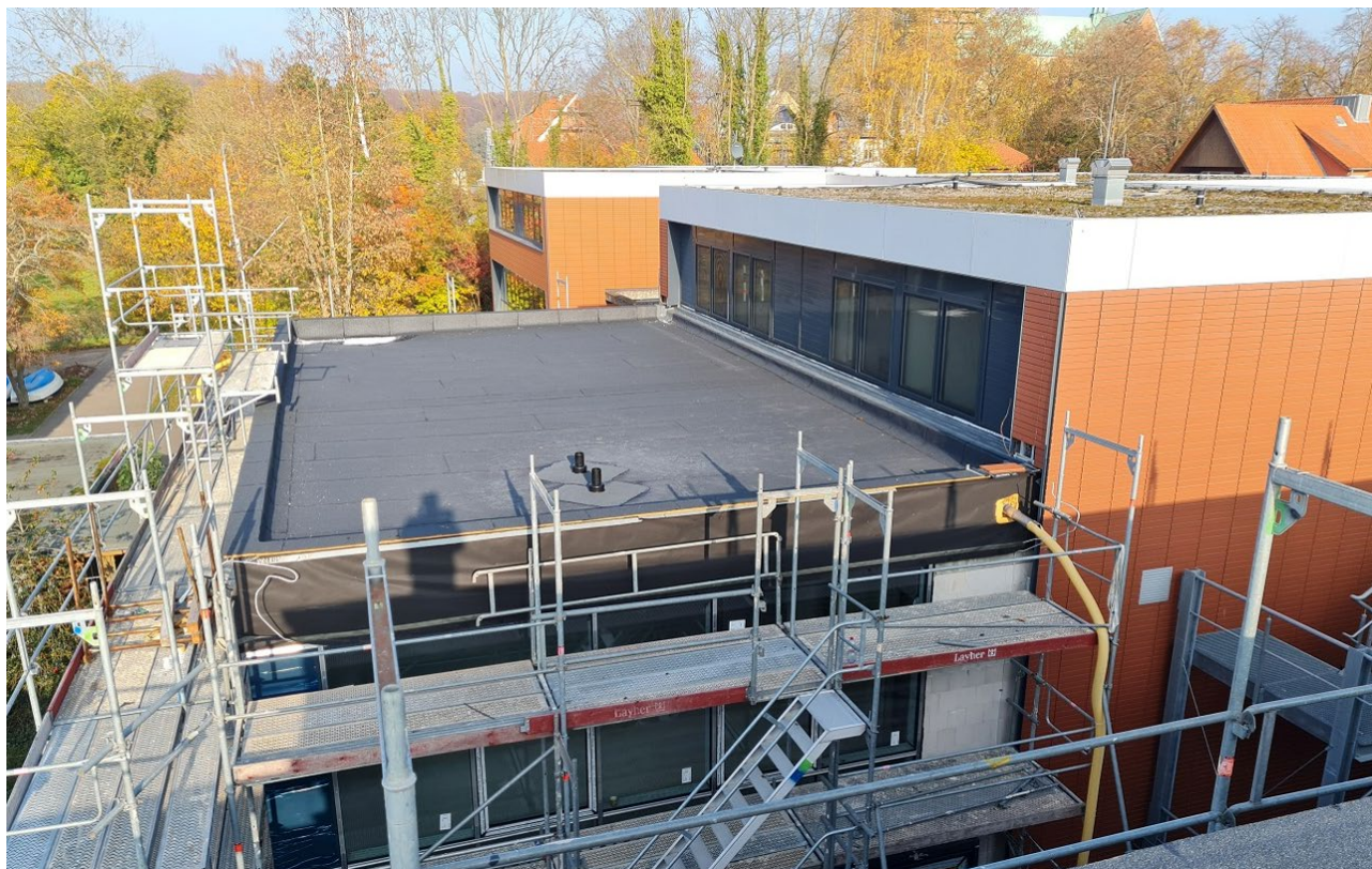
Abbildung 5: Dachabdichtung Anbau Mensa
