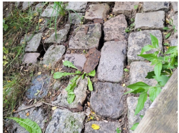
2024_FUGENBEREICHE AUSGEWITTERT MIT BEWUCHS
