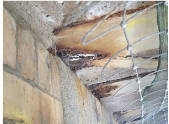
2024_BINDEBLECH MIT KORROSION
