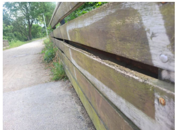
2024_GELÄNDER BRETTER VERMODERT
