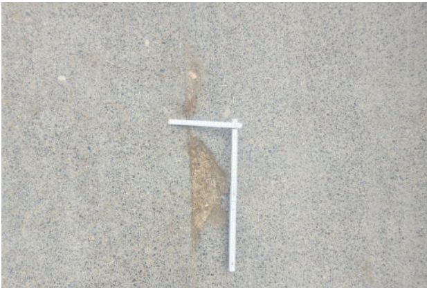
2024_BELAG MIT AUSBRÜCHEN
