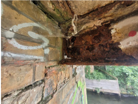
2024_KONSOLE DES KRAGARMES DURCHKORRODIERT
