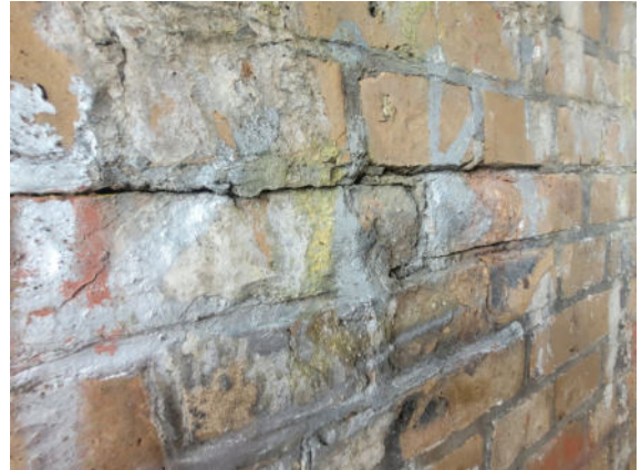
2024_MAUERWERK MIT AUSBRÜCHEN
