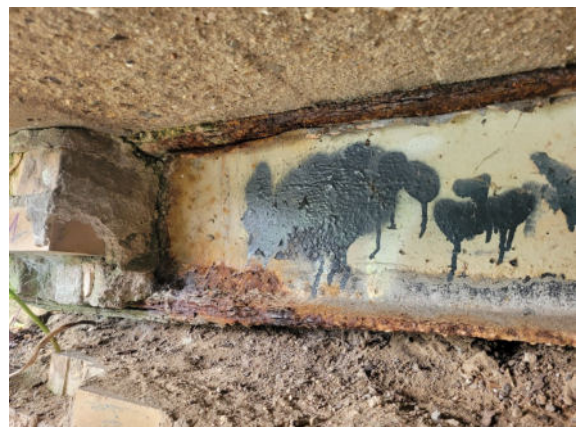
2024_WALZTRÄGER MIT SPALTKORROSION
