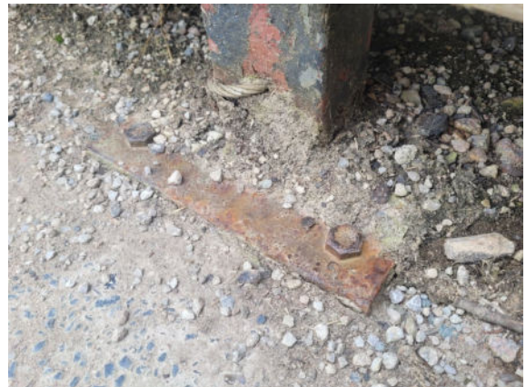
2024_PFOSTENVERANKERUNG NICHT FACHGERECHT
