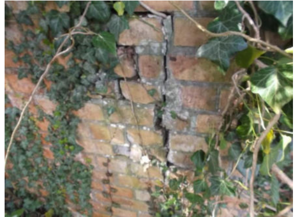
2018_RISS IN FLÜGELWAND
