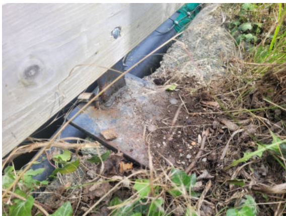
2024_KORROSION IM FUSSPUNKTBEREICH DES GELÄNDERPFOSTEN
