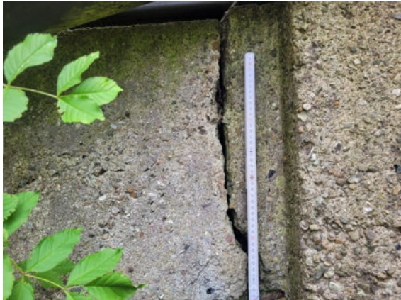
2024_FLÜGELWAND BETON GERISSEN
