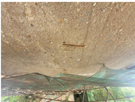
2024_ABPLATZUNG MIT FREILIEGENDER BEWEHRUNG
