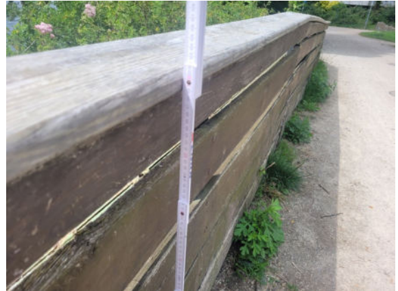
2024_GELÄNDER ZU NIEDRIG
