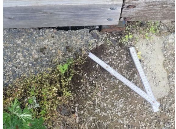
2024_GESIMS MIT BETONABPLATZUNG
