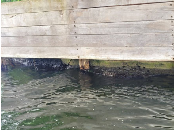
2024_BETON AUSBRUCH IN WWZ
