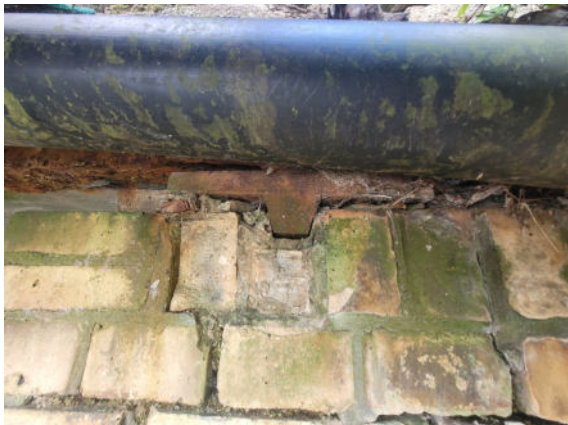
2024_AUFLAGER DER WALZTRÄGER MIT KORROSION
