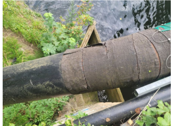
2024_ROHR MIT SCHADHAFTER SCHÜTZUMMANTELUNG
