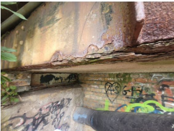
2024_SPALTKORROSION AM TRÄGER
