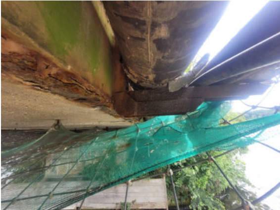
2024_KONSOLEN DER LEITUNGSBEFESTIGUNG MIT KORROSION
