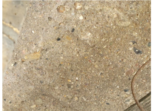
2024_BETON OBERFLÄCHE VERWITTERT
