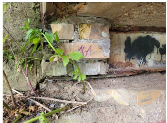
2024_MAUERWERKSAUSBRUCH IM FLÜGEL
