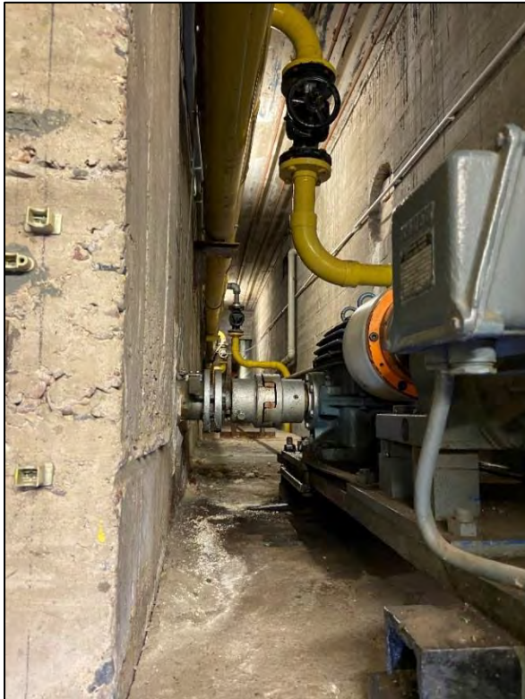
Foto 11: Gut einsehbare Kellerräume des Aqua Siwa. Höhere Temperaturen, hohe Luftfeuchtigkeit sowie lärmintensivere Pumpen entsprechend der Nutzung als Schwimmbad.
