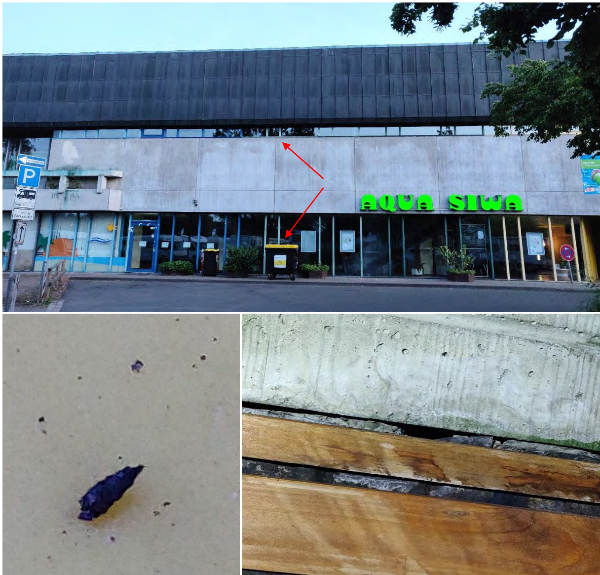
Abb. 6: Nachweis eines möglichen Zwischenquartiers an der Fassade des Aqua Siwa im Juni 2022 durch Kotreste.
