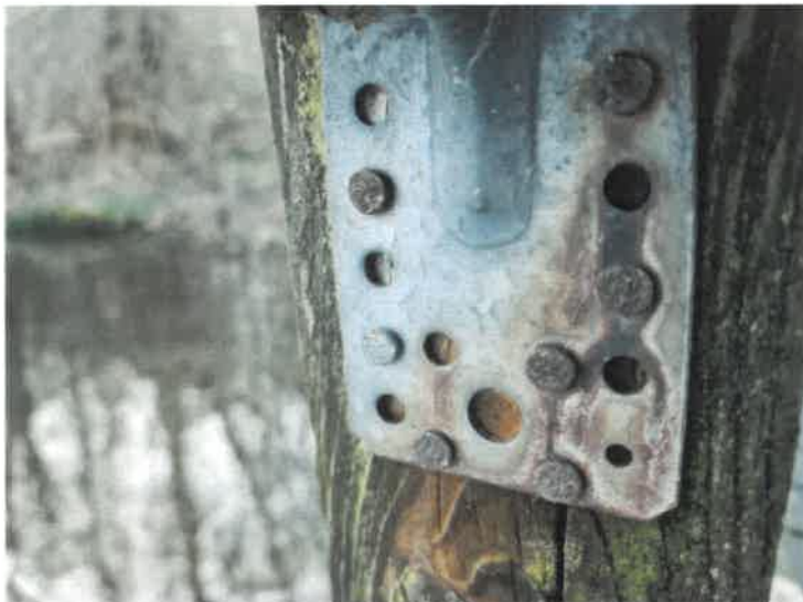
2024_VERBINDUNGSMITTEL GELÄNDER KORRODIERT
