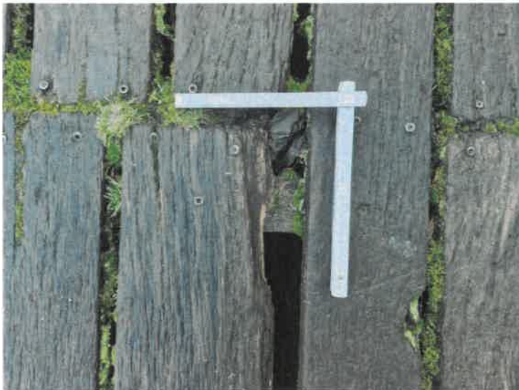
2024_BOHLENBELAG MIT AUSBRÜCHEN
