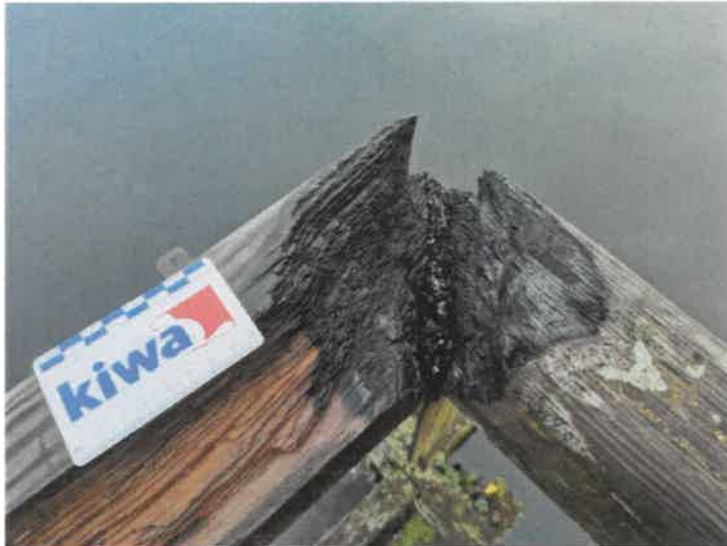
2024_GELÄNDER BESCHÄDIGT DURCH FEUER
