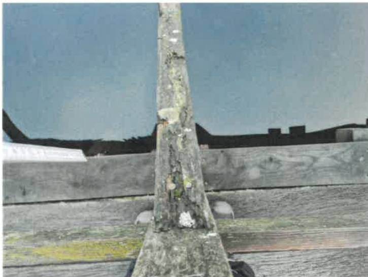
2024_GELÄNDER DIAGONALTRÄGER VERFAULT
