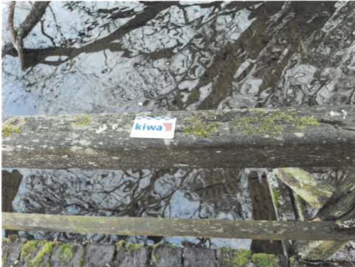
2024_GELÄNDER MIT MOOSBELAG
