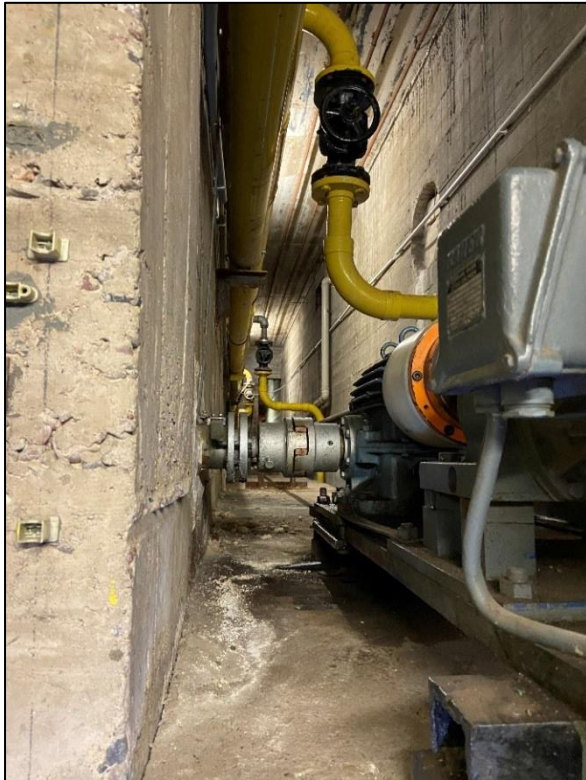
Foto 11: Gut einsehbare Kellerräume des Aqua Siwa. Höhere Temperaturen, hohe Luftfeuchtigkeit sowie lärmintensivere Pumpen entsprechend der Nutzung als Schwimmbad.
