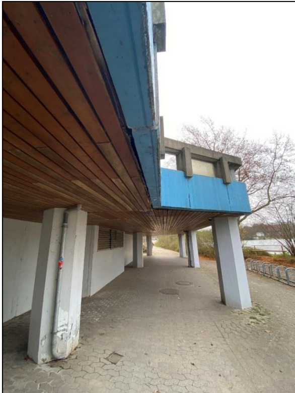
Foto 5: Kleinbahndamm südlich des Aqua Siwa. Holzverkleidung mit Lücken und Spalten.
